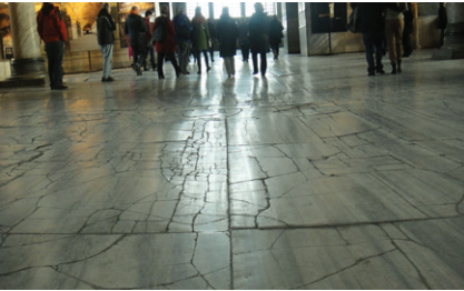
Şekil 27. Taban döşemesindeki Marmara mermerinde görülen çatlak ve kabarmalar (Fotograf: S. Angi).
