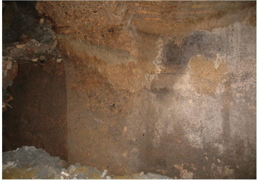
Şekil 10. Vidinli Tefrik Paşa Caddesi Sarnıcı duvarındaki hidrolik siva kalıntısı.
