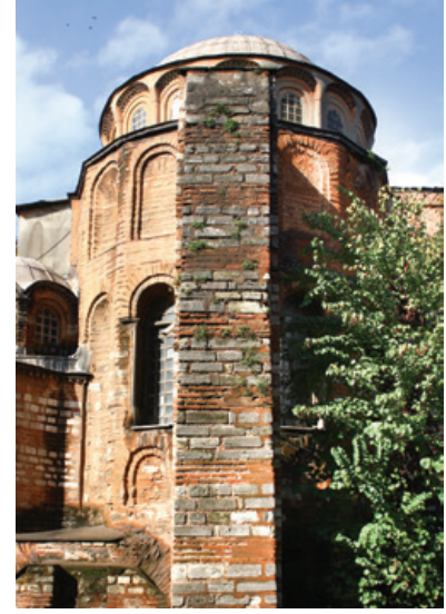
Yüksek dozlu Portland çimento bağlayıcılı derz yüzeyleri.
