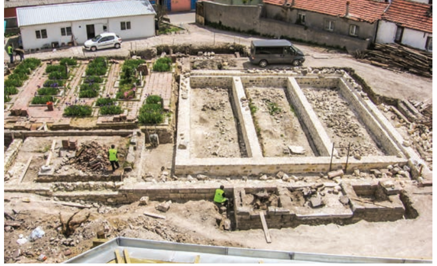
Şekil 9. Semahane temellerinin sağlıklılaştırılması aşaması
