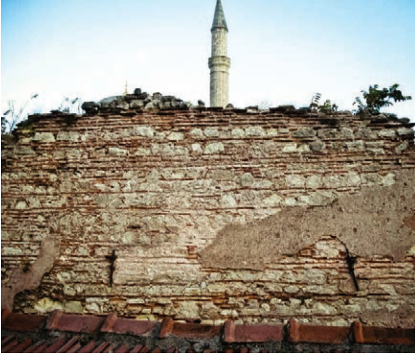
Şekil 10. Yapının kuzeybatı cephesinde dökülmeden kalmış olan sivalar
