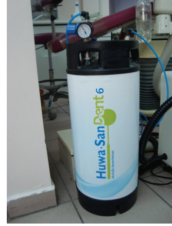
Şekil 10. Diş üniti su yolu sistemine biyofilm çözücüsü olarak tanımlanan hidrojen peroksit koloidal gümüş uygulaması
