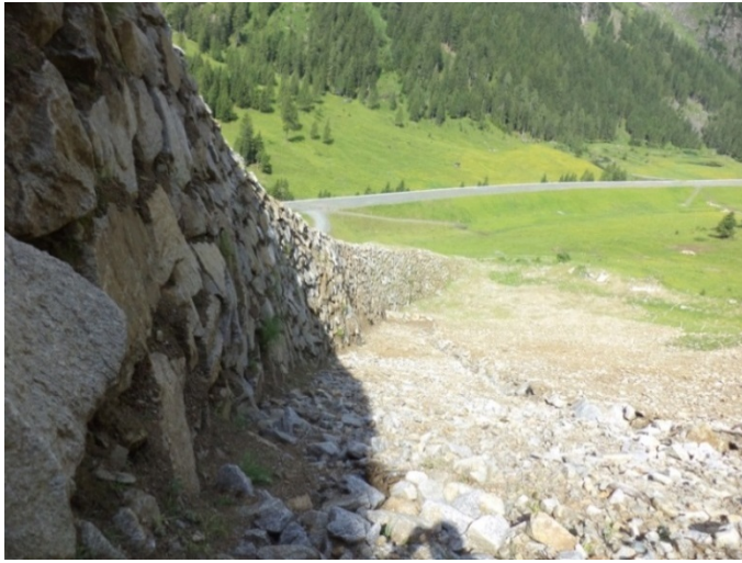
Şekil 11. Karayolunu çığdan korumak için yapılmış bir saptırma duvarı örneği (Avusturya)
