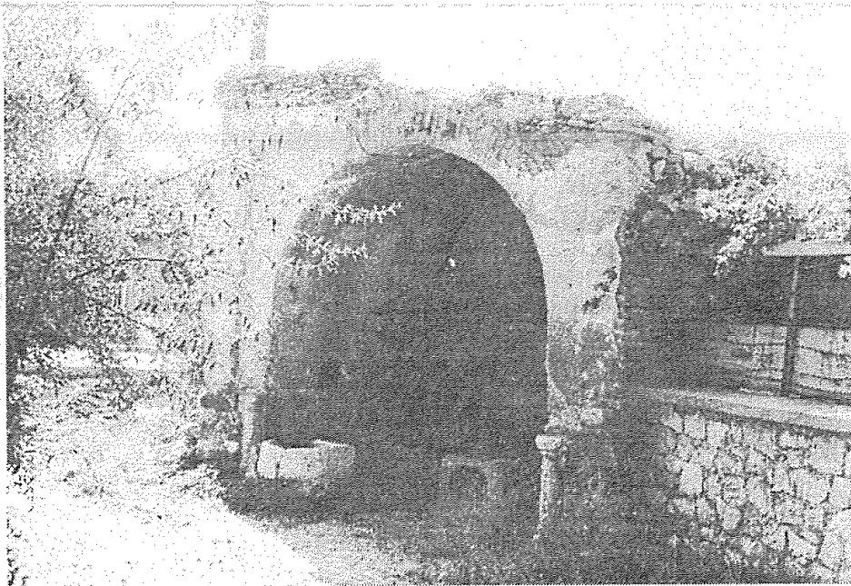
Res.7- Ak Sarnıç'ın restorasyondan önceki hali.
