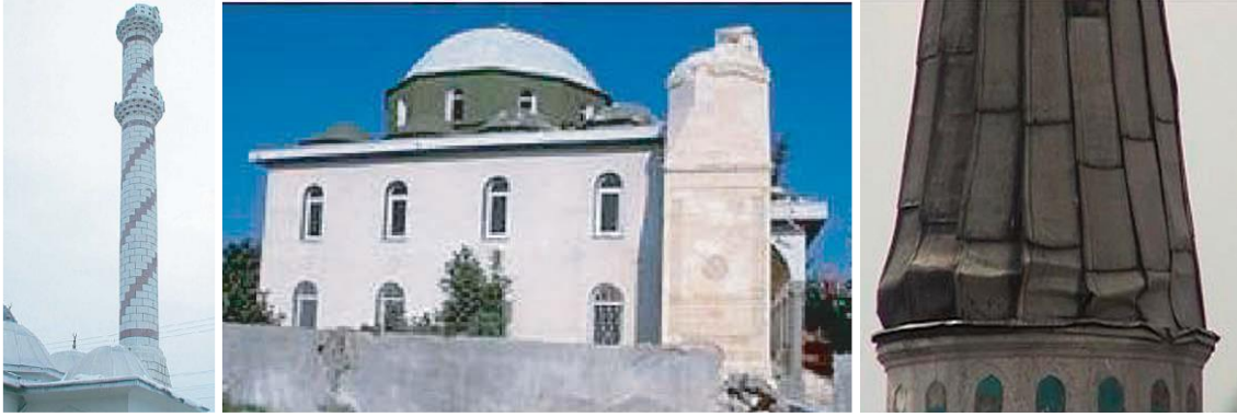
Şekil 3. Deprem etkileri altında minarelerin hasara uğradığı bölümlere örnekler [5]
