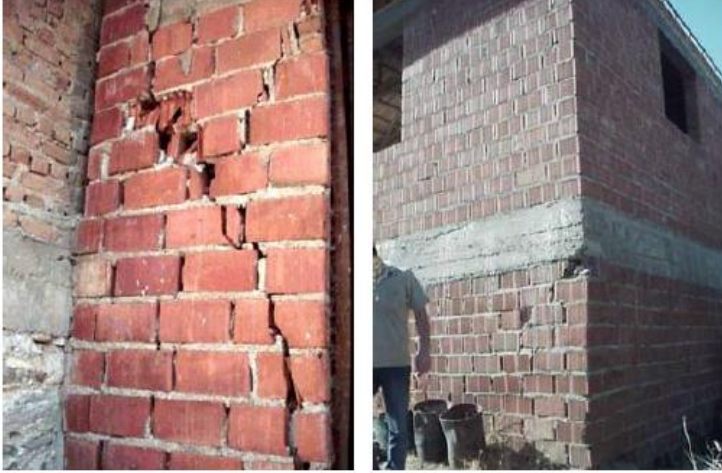
Şekil 2.6. Yığma yapıda oluşan kesme etkili duvar hasarları (PÜ, 2003)
