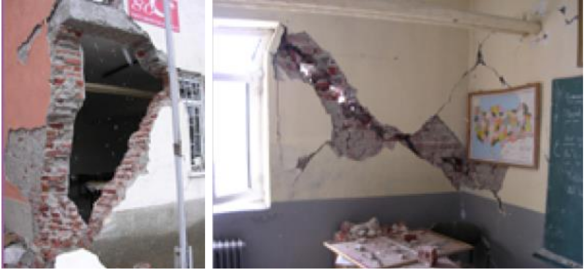
Şekil 2.4. Kandilli kasabesindeki yüksek hasarlı yığma okul binası (2004 Erzurum depremi) (Şimşek, 2005)
