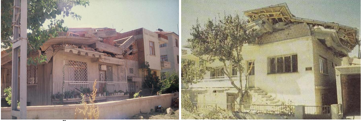
Şekil 2.16. (a) Üst katları televizyon tuğladan yapılmış ve yıkılmış yapı (1995 Dinar depremi) (Bayülke, 2011) (b) Üst katı boşluklu tuğla ile yapılmış yığma binada deprem hasarı (1995 Dinar Depremi) (ODTÜ, 1995)
