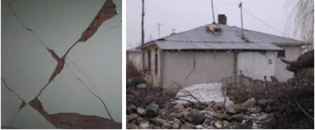
Şekil 2.3. (a) Yığma duvarlarda oluşan tipik kesme çatlak (Doğangün vd, 2008) (b) Çayköy'de 84 Balkaya depreminden sonra devlet tarafından yaptırılan yığma binadaki duvar hasarı (Şimşek, 2005)
