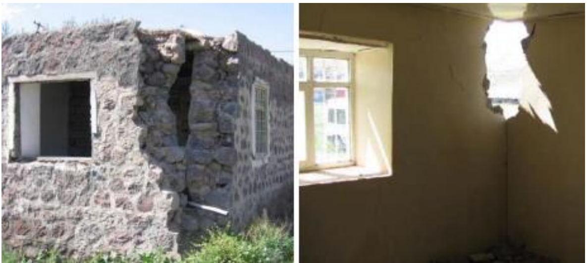
Şekil 2.9. Yığma yapılarda birleşim bölgelerinde oluşan ağır hasarlar (Bayraktar vd, 2007).
