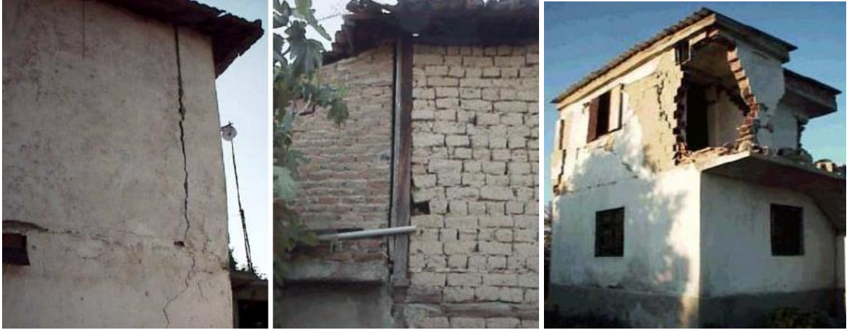
Şekil 2.8. Yatay ötelenmeden dolayı köşe noktalarında oluşan ayrışmalar ve köşe hasarları (2003 Buldan/ Denizli Depremi) (PÜ, 2003).
