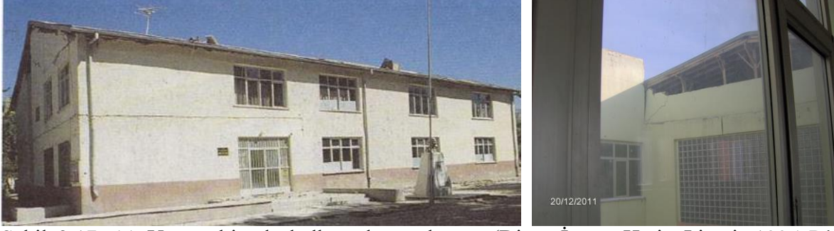
Şekil 2.17. (a) Yığma binada kalkan duvarı hasarı (Dinar İmam Hatip Lisesi, 1995 Dinar depremi) (ODTÜ, 1995) (b) Kalkan duvarı hasarı (2011 Van depremi) (Alıcıoğlu, 2012)
