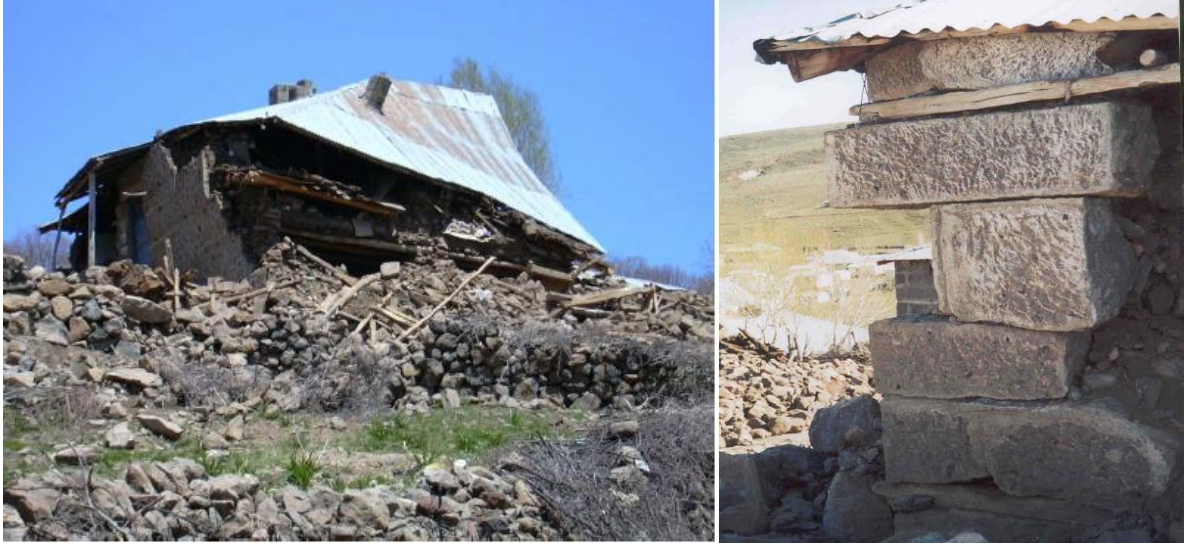
Şekil 2.7. (a) Zayıf ve gevşek köşe bağlantılı bina (b) Rijit yapılı köşe bağlantısı (2003 Bingöl depremi) (Karaşin, Karaesmen, 2005).
