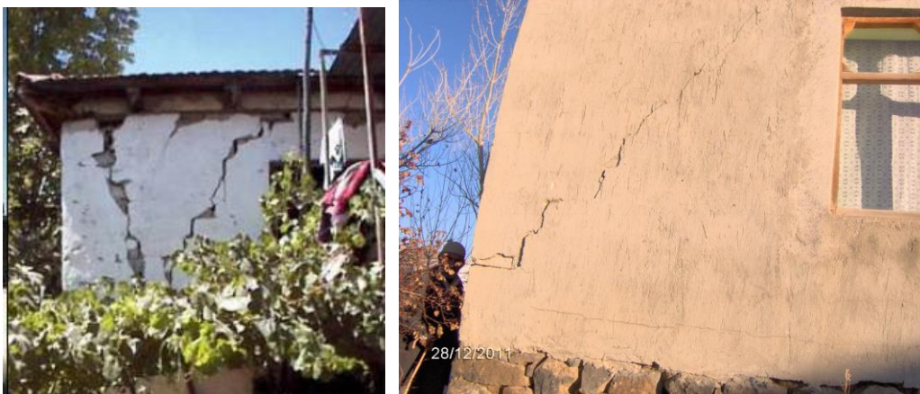
Şekil 2.5. (a) Yığma yapılarda görülen duvar hasarları (1992 Erzincan depremi) (Çırak, 2011) (b) Duvar ayrışması (2012 Van depremi) (Alcıoğlu, 2012)
