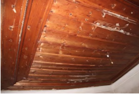
Şekil 58. Çıtalı Ahşap Tavan Kaplaması (Nurcan K. Mim., Çorum Bel. Etüt Proje Müd. Arşivi)
