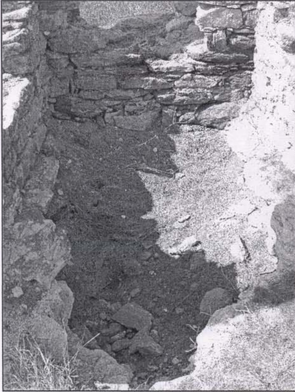
6. Edirne- Süloğlu- Tatarlar Köyü Türbesi'nin tahrip edilmiş iç mekanı
