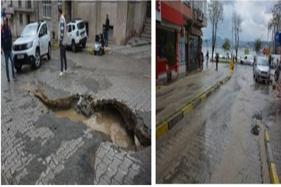
Şekil 6. Ordu ilinin Ünye İlçesinde Şebeke Suyu nedeni ile Taşkın Oluşumu
