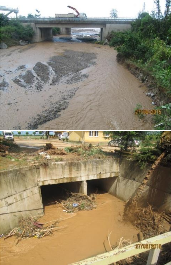
Şekil 4. Köprü ve Menfezlerin Tıkanması
