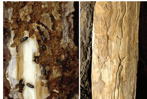
Şekil 9. Bazı ahşap zararlıları ve oluşturdukları hasar
