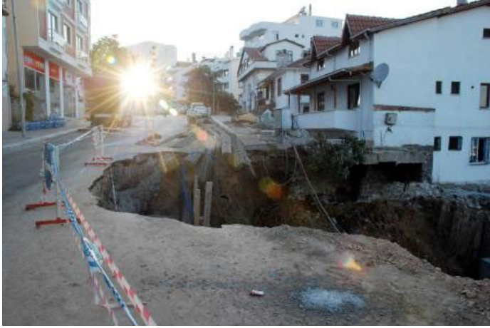
Şekil 29. Düzce Akçakoca'da meydana gelen temel kazısının göçmesi.
