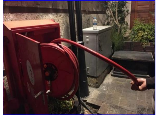
Şekil 9. Yangın hidrantlarının illegal kullanım örneği
