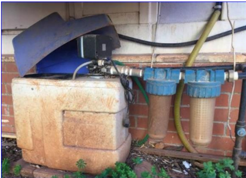
Şekil 8. Sayaç öncesine takılmış su yumuşatma/arıtma cihazı.
