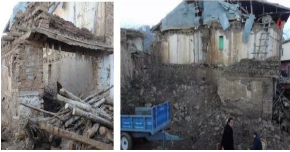
Şekil 17. Malatya Doğanyol’da deprem etkisiyle yıkılan bir kerpiç yapı [49]
