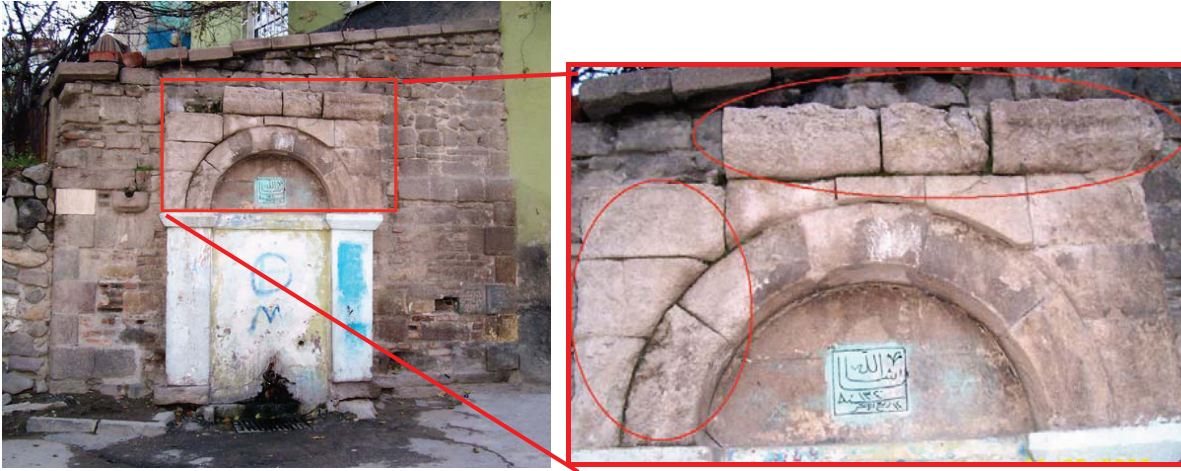
Şekil 15. Hacı Nasuh çeşmesi yapımında kullanılan volkanik kayalarda oluşan bozunmaların genel görünümü.
