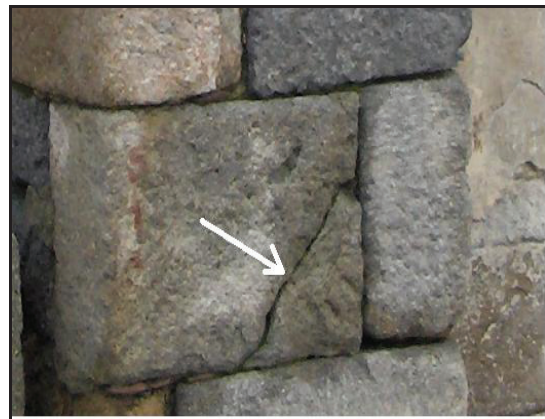
Şekil 8. Abdi Kadı çeşmesindeki volkanik kayalarda oluşan çatlaklar.
