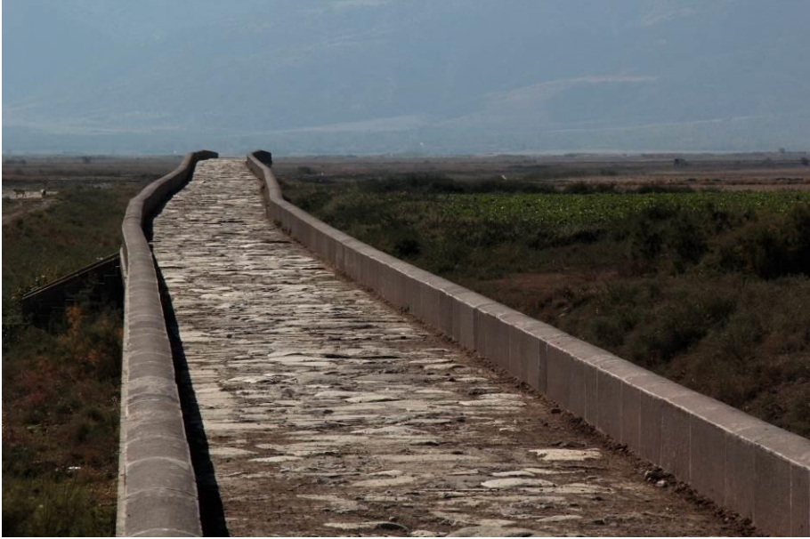
Fotoğraf 28: Köprü eksenindeki kırılmalar (2017)
