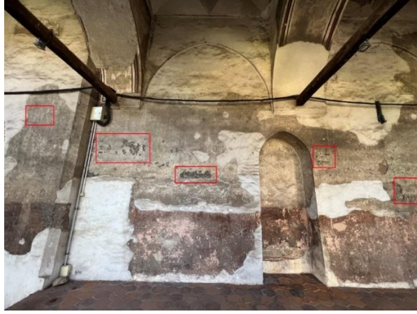
Resim 54: Son cemaat yeri beden duvarında kalem işinden yazı kalıntıları.
