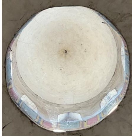
Resim 63: Sofanın üstünü örten kubbenin aydınlık feneri kasnağında kalem işi uygulamaları. Sofanın kubbeye geçiş elemanları pandantifler mukarnas dolgularla zenginleştirilmiştir. Mukarnas dolguların yüzeyinde kalem işi bezemelerin olduğu 1969 yılına ait fotoğrafta kısmen takip edilebilir.
