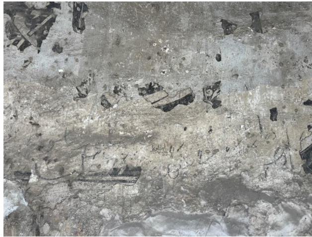
Resim 56: Son cemaat yeri beden duvarında kalem işinden yazı kalıntılarında detay.
