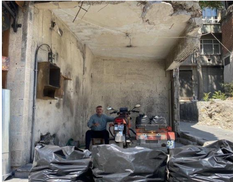
Şekil 4. Depremde ağır hasar alan ve duvarı yıkılan bir yapının görüntüsü (güneydoğu ekspres, 2023)
