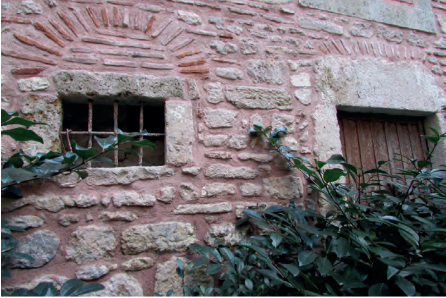
F.4- Bodrum kat pencere ve kapı örneği, (2012)
