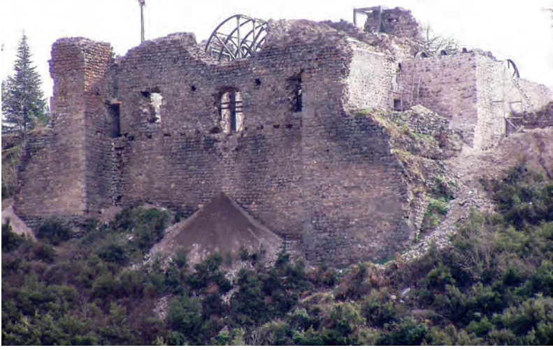
F. 21- Yağlıbasan Medresesi'nin sur duvarına oturması (Niksar Belediyesi Arşivi, 2008)
