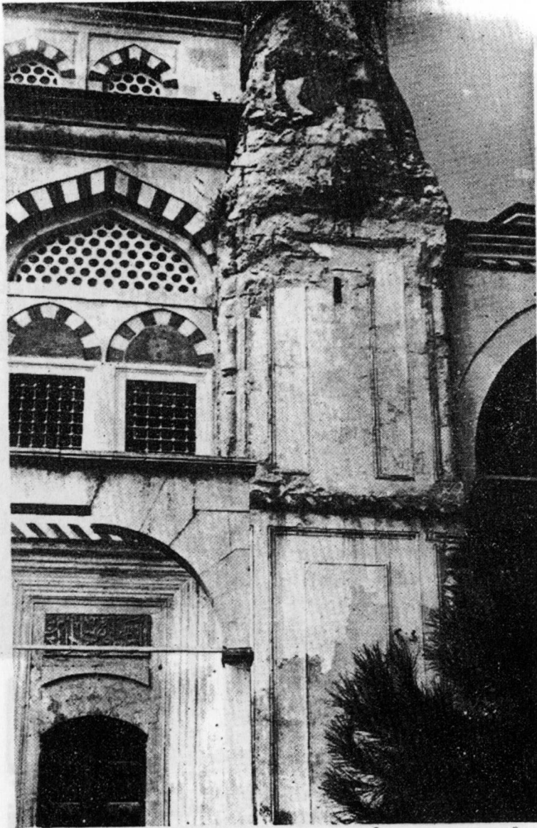
Resim 7 — Muradiye Camiinin minare pabuçu (Onarımdan önce)
