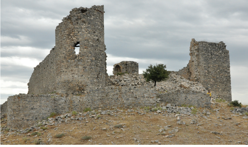
Resim 8 - İç kalenin batı beden duvarının 2005 yılında yıkıldıktan sonraki durumu. (Fot. Mimar H. Fevzi Çüçen, 2012.)
