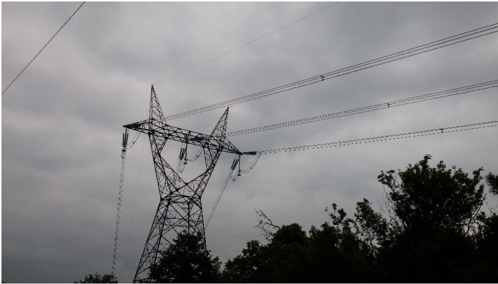
Şekil 3. 380kV Pheasant hattının ölçüm yapılan noktadan görüntüsü (View of 380kV Pheasant line from measurement point)
