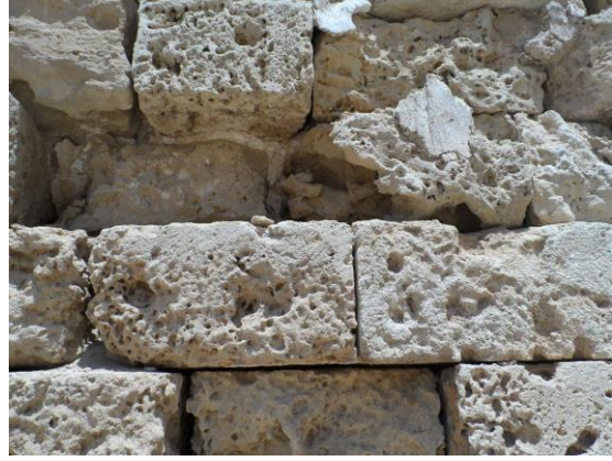
Şekil 8. Gazimağusa Kaleiçi St. Nikolas Katedrali giriş cephesinin iç kısmının yapı taşlarında görülen parça kayıpları, yüzeysel erimeler ve çukurlaşmalar
