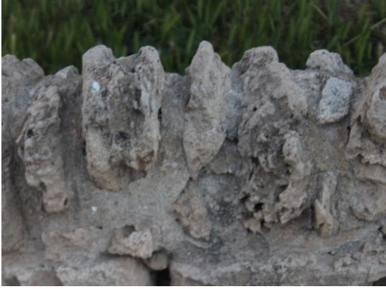
Şekil 14. Gazimağusa Kaleiçi kale surları ön cephesindeki yapı taşlarında tuz etkisi ile oluşmuş yüzeysel erozyonlar
