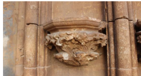
Şekil 5. Gazimağusa Kaleiçi Lala Mustafa Paşa Camiisi giriş cephesinde görülen kırılmalar
