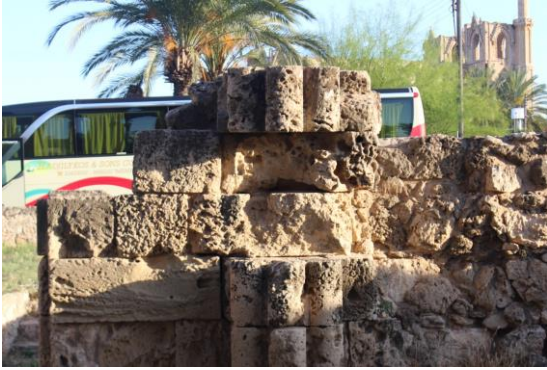
Şekil 11. Gazimağusa Kaleiçi St. Nikolas Katedralindeki yapı taşlarında görülen erime ile oluşmuş büyük parça kayıpları
