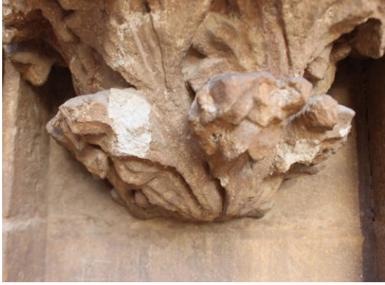
Şekil 6. Gazimağusa Kaleiçi Lala Mustafa Paşa Camiisi giriş cephesinde görülen çukurlaşmalar
