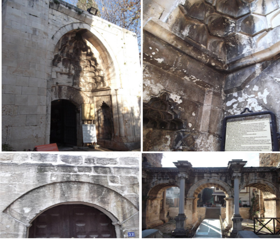
Şekil 8. Özellikle şehir merkezine yakın olan yapılarda sıklıkla görülen atmosferik kirlenme, yoğun şekilde kendini hissettirmektedir.
