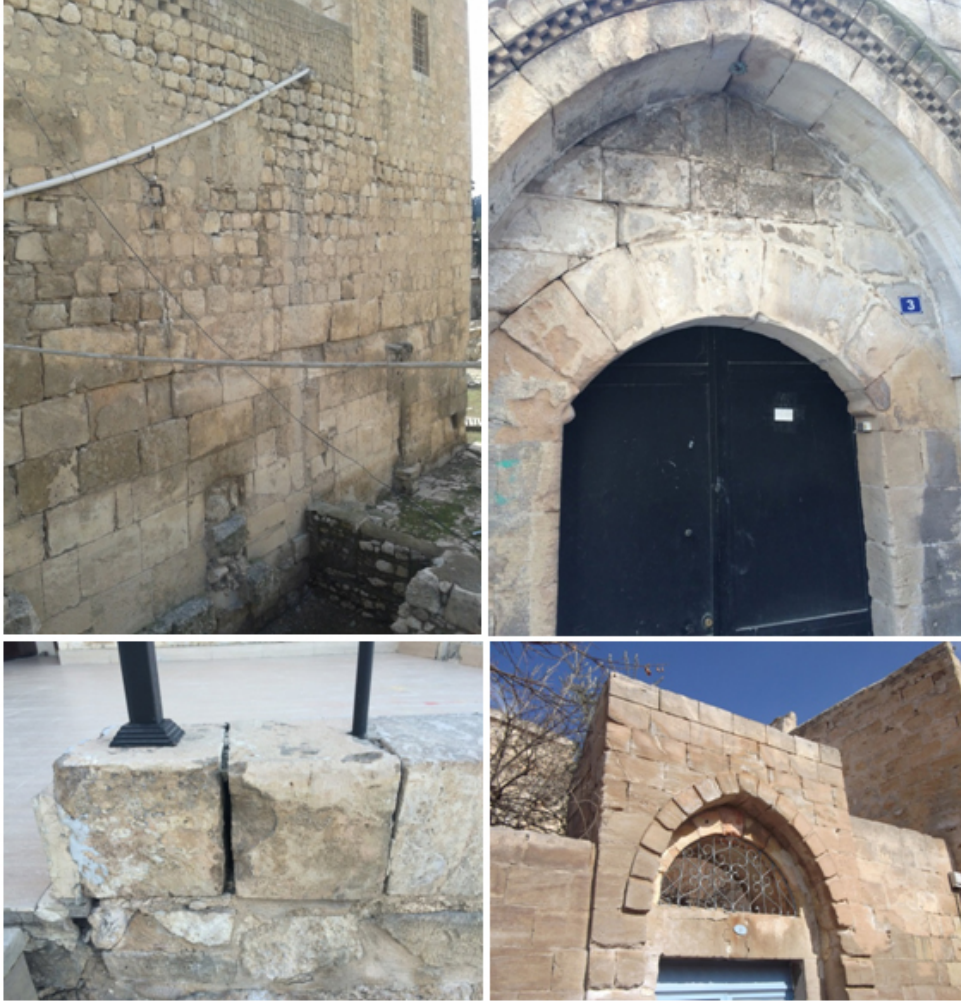
Şekil 7. Birçok tarihsel yapıda gözlenen derz boşalmasıyla ilgili ayrışma türlerine örnekler.
