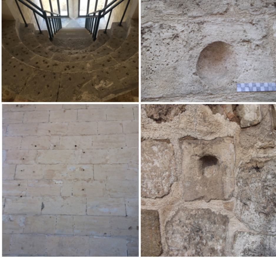
Şekil 5. Bazı tarihsel önemi büyük olan yapılarda gözlenen oyuklanma şeklindeki bozunmaya örnekler.
