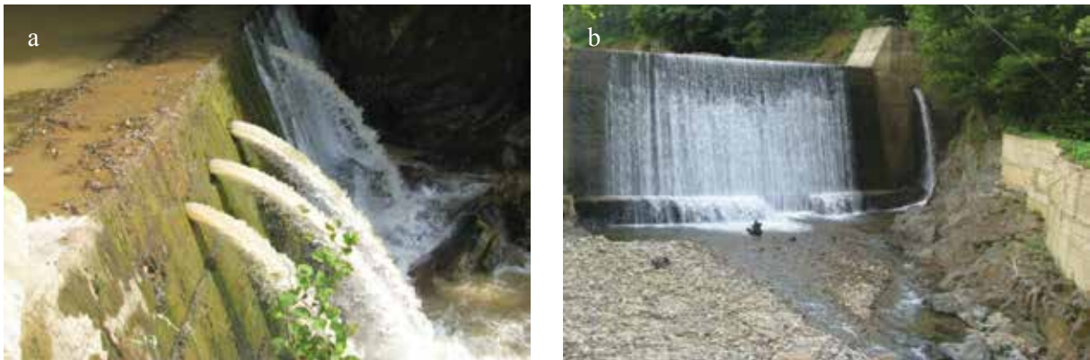
Şekil 15. a, b. Güneysu deresi üzerine inşa edilen sel taşkın bentleri. Bu bentlerin yüksekliği 8 m'dir. Beton malzemeden inşa edilen bu bentlerde balık geçidi bulunmamaktadır (Temmuz, 2011, Rize, Güneysu).
