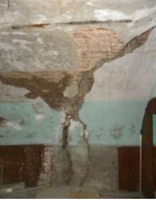
Resim 15. Abdullah Paşa Sıbyan Mektebi, Z-02 Mekânı Çatlaklar (MDM Mimarlık Proje Tasarım ve Antika Müzayede Tic. Ltd. Şti. Arşivi, Haziran 2016)
