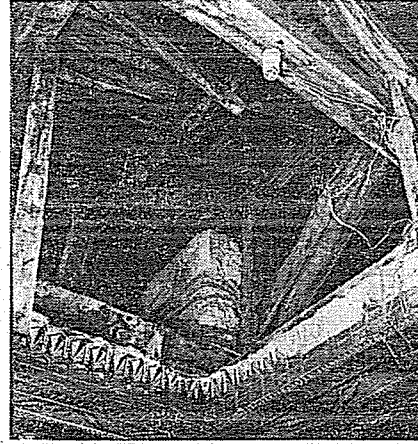
Resim 21. Çatı arasındaki yıkık beşik tavan boşluğu.
