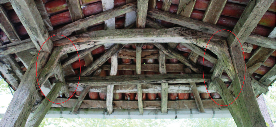
Fot. 28: Kiremitli Köprü Doğu Girişte Çatı Ayrıntısı. (İşaretli kesim: Çatı kirişine sonradan yapılan ilave.)
