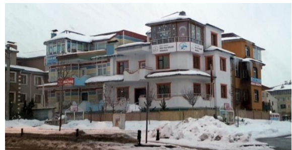
Resim 4-6. Çatı formu ve çatıdaki engeller çatıdaki karın tahliyesine engel olmaktadır
