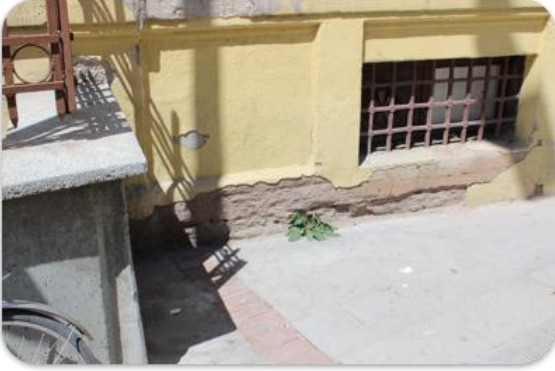
Resim 7. Yapı malzemesinde kapiler su etkisi ile meydana gelen hasar.
