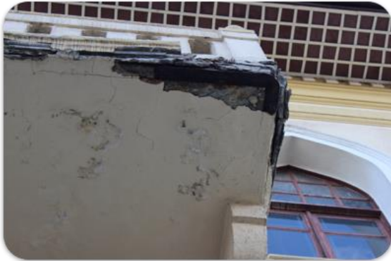
Resim 1. Damlalık detayı yapılmamış balkon Figure 1. Balcony without dropper detail
