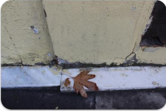
Resim 9. Yapının zeminle birleştiği noktalarda yanlış detaylandırmalar.
