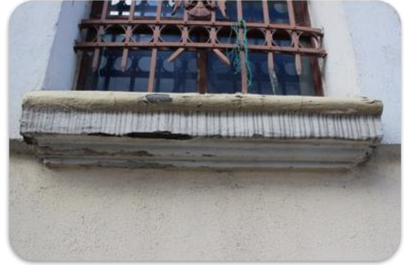
Resim 4. Damlalık yapılmamış pencere denizliğinde meydana gelen hasarlar
