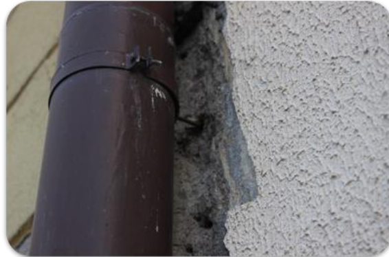
Resim 17. Genleşen çatlaklardan parçalar kopmaya başlayarak zaman içinde hasarlar büyümektedir.
