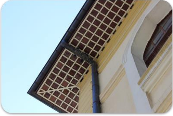
Resim 24. Kuşlar yapı cephe kaplamalarına zarar verebilirler.
