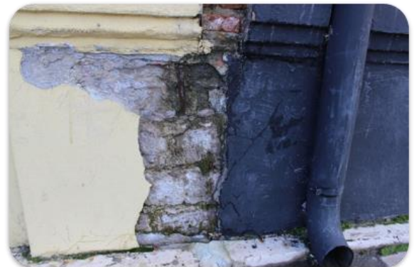
Resim 21. Yağmur borularında bakım onarım yapılmaması sonucunda su etkisi cephe kaplama malzemelerinde hasar oluşturur.
