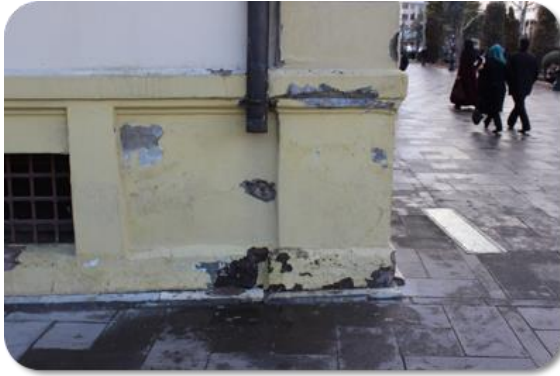
Resim 20. Yağmur indirme borularının işlevini yerine getiremeyecek şekilde hasar görmesi.
