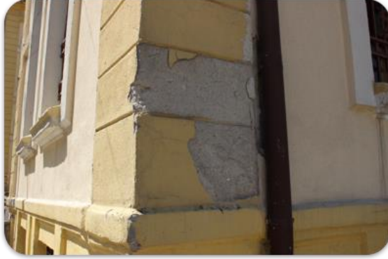
Resim 26. İç yapısı bozulmuş taş yüzeylere yapılan kaplamalarda meydana gelen hasarlar. Figure 26. Damages occurred on the coverings applied on stone surfaces with deteriorated inner structure
