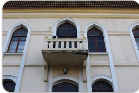
Resim 2. Balkonun hasara uğramış kısımlarının genel görünüşü Figure 2. General view of the damages on the balcony
