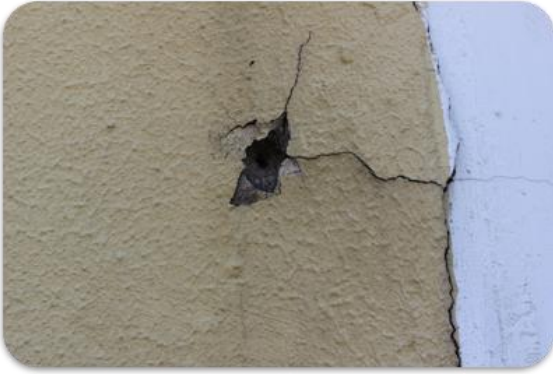
Resim 16. Montaj için kullanılan vida deliği, genleşme farklılığından meydana gelen çatlaklar.
