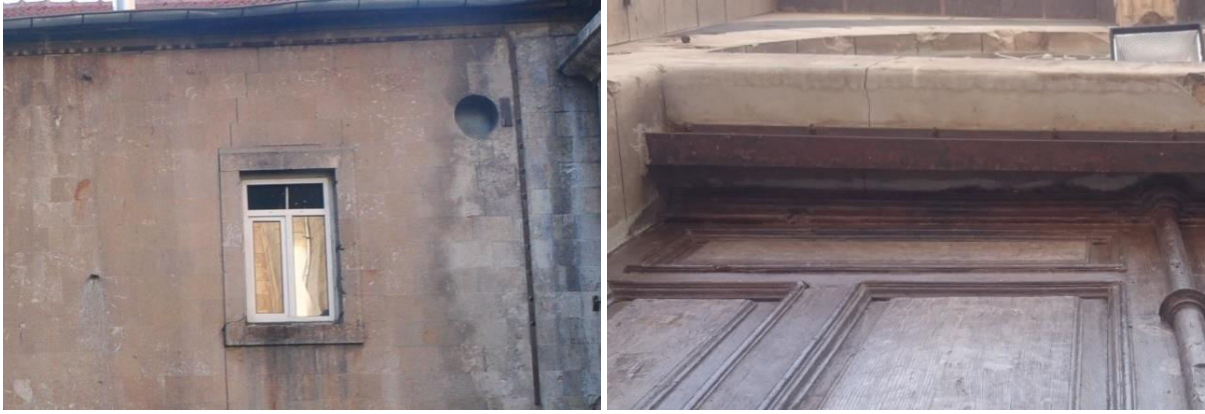
Şekil 15. Okul cephesi don etkisiyle ortaya çıkan derz ayrılmaları, kilise lentosu
