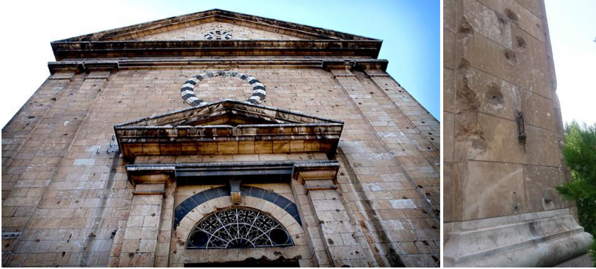
Şekil 17. Kilise doğu cephesinde şarapnel izleri
