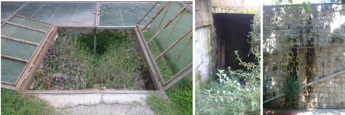
Şekil 16. Geçit merdiveni bitki oluşumu, avlu duvarlarında otsu bitki ve yosun
