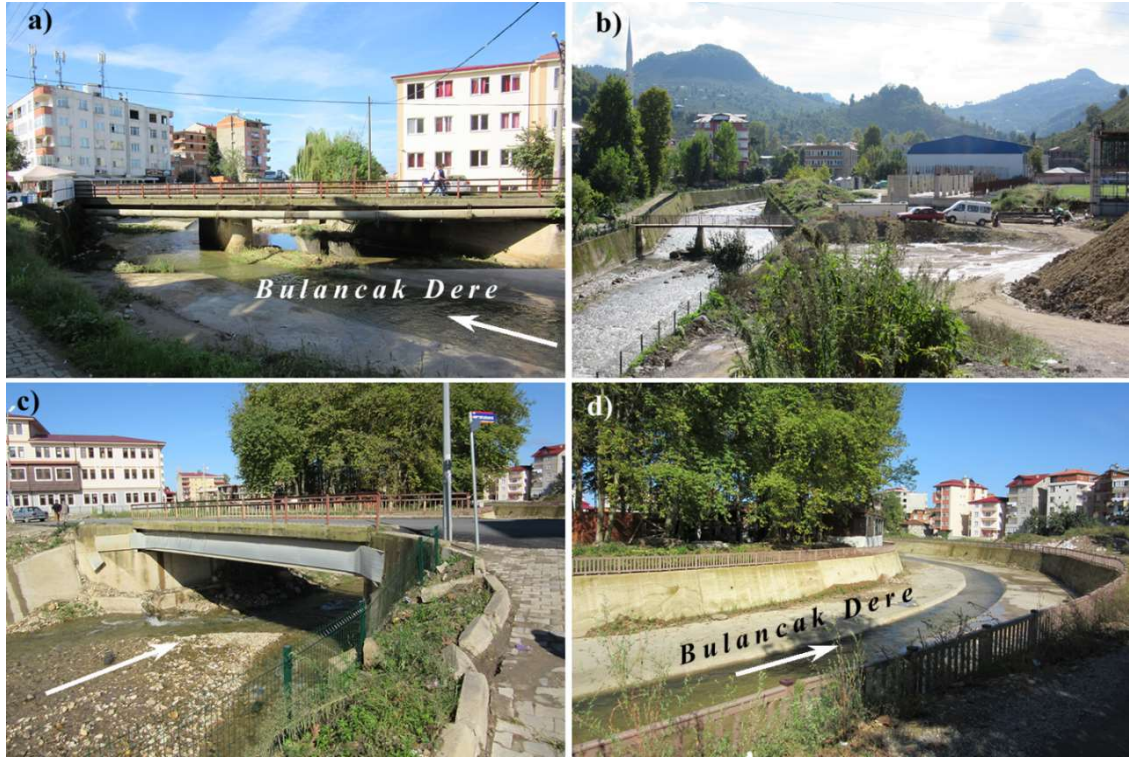
Foto 4. Bulancak'ta yerleşmeleri en fazla etkileyen Bulancak Deresi'nin yerleşme içerisinde kalan bölümündeki yapısal hatalar. a) Kanal üzerinde akışı yavaşlatan ve yatak profilini daraltan köprü, b) Yatak içerisinde yapılan bina ve tesislerin yatağı daraltması, c) Köprü yapımı için yatak daraltılması ve d) Kanallarda kavislerin varlığı sel ve taşkın riskini artırmaktadır.
