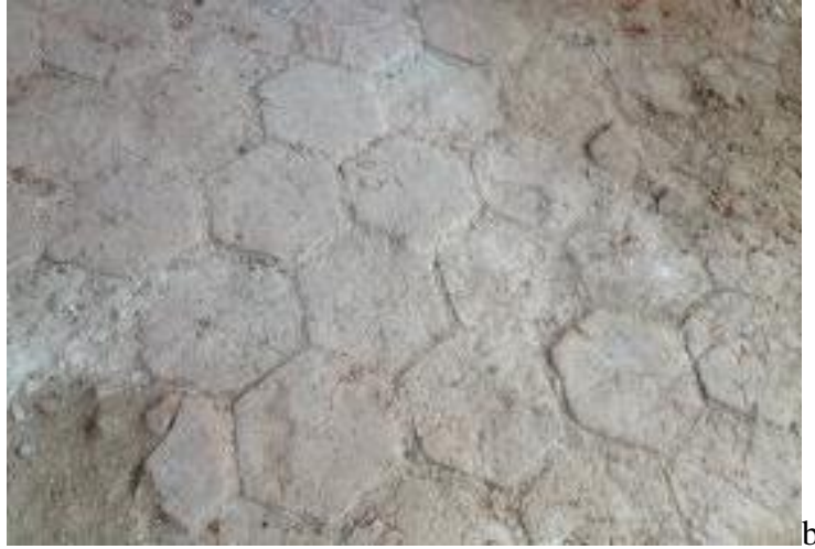
Resim 13. Beton katmanın sökülmesi ile ulaşılan harim (a) ve son cemaatte seki üstü zemininin (b) özgün tuğla döşemesi. (Kaynak: Yazarlara ait fotoğraf arşivi, 2015).
