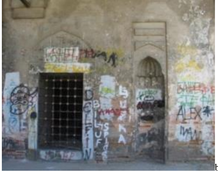
Resim 10. Silmelerde atmosferik koşullar ve detay hatasına bağlı yüzeysel erimeler (a), son cemaat güney duvarında grafitti (b). (Kaynak: Yazarlara ait fotoğraf arşivi, 2015, 2013).
