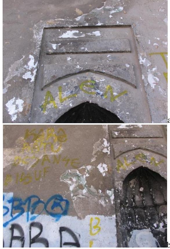
Resim 19. Onarım öncesinde son cemaatin doğu bölümünde görülmekte olan kalemîşi bezemeler (a,b). (Kaynak: Yazarlara ait fotoğraf arşivi, 2013).
