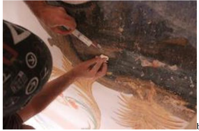
Resim 25. Kalemî alanlarda kimyasal temizlik çalışması (a) ve IV. dönem duvar resimlerinde boya sağlamlaştırma çalışması (b). (Kaynak: Vakıflar Genel Müdürlüğü Arşivi, 2016)
