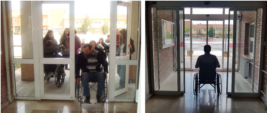
Fotoğraf 7-8. Standart geçiş genişliğine sahip olmayan Dekanlık Binası giriş kapısı eski ve yeni hali.
