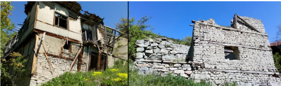
Şekil 6. Harabe Durumdaki Konut ve Samanlık Yapısı
