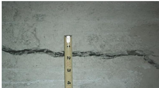
Resim 3. Portland çimentolu betonda rötre çatlakları [11]
