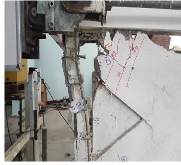
Paneli çerçeveye bağlayan ankrajda kopma ve kolonda oluşan kalıcı hasarlar.
