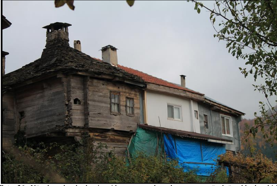
Foto 36. Yörede geleneksel mimaride yaşanan degradasyona en güzel örneklerden biri: Genişletme ve tamirat çalışmaları geçiren ve her seferinde farklı malzeme kullanılan bir kırsal konut. Solda ahşap duvar ve pencere ile taş çatı örtülü geleneksel mimari özellikleri taşıyan bölüm. Ortada , Marsilya tipi kiremit ile örtülü ve plastik malzeme ile dış cephe kaplaması yapılmış, pencereleri PVC olan bölüm. Sağda , sac çatı örtüsü kullanılmış ve sac malzeme ile dış cephe kaplaması yapılmış, pencerelerin bir kısmı ahşap bir kısmı PVC malzeme olan bölüm (Bakırlı Zaviye/Ayancık).
