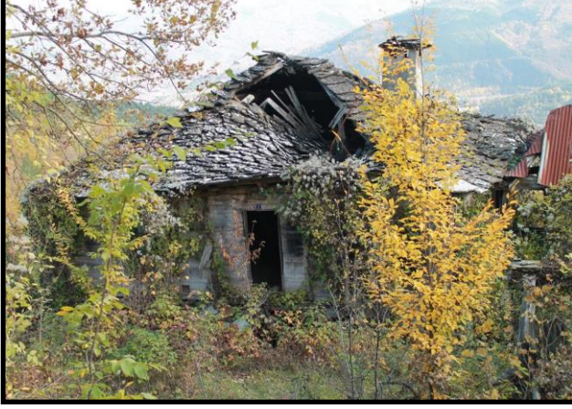
Foto 14. Terkedildiği için bakımsız kalan ve sonrasında çatısı çöken bir köy evi (Babaçay Köyü/Ayancık)
