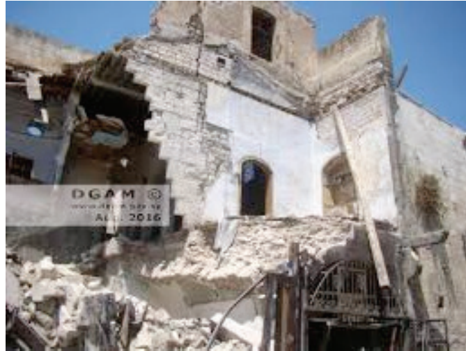
Şekil 25 : Gazali Evinin doğu bölümündeki hasar - (DGAM, 2016)
