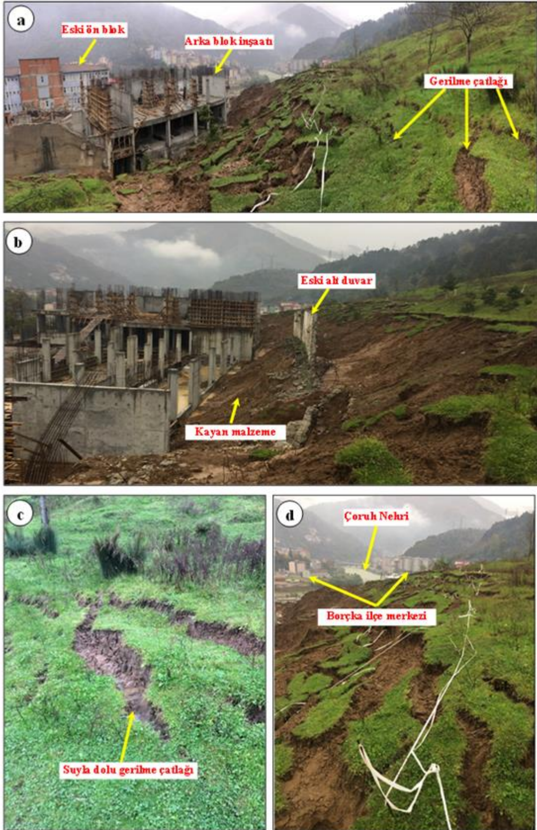
Şekil 3. Zemin şevinde meydana gelen gerilme çatlakları
