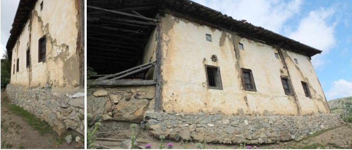
Fotoğraf 7-8: Güney Cephe ve Yapıyı Desteklemek Amacıyla Moloz Taşlarla Yapılan Set
