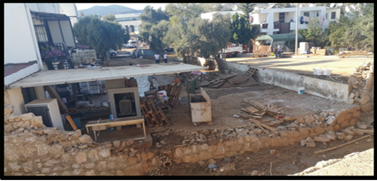
Fotoğraf 2 - Taşkın zararlarına sebep olan başlıca unsurlar (Yan duvarlar) (devam)
