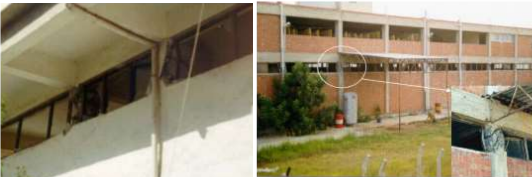
Şekil 11. (a) Kısa kolon etkisi ile hasar gören bir yapı, Adapazarı depremi. (b) Kısa kolon etkisi ile hasar gören bir yapı, Ceyhan depremi (Çağatay (2007)).
