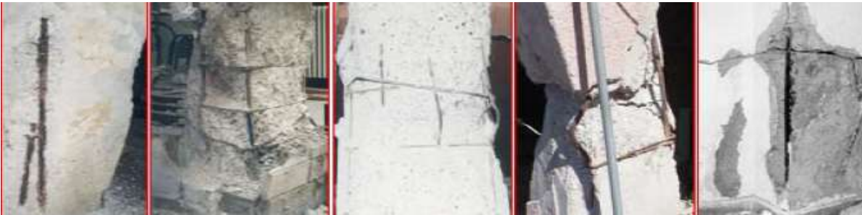
Şekil 6. 1999 İzmit depreminde Eskişehir’de hasar gören yapılarıdaki korozyonlar (Doğan (2009)).
