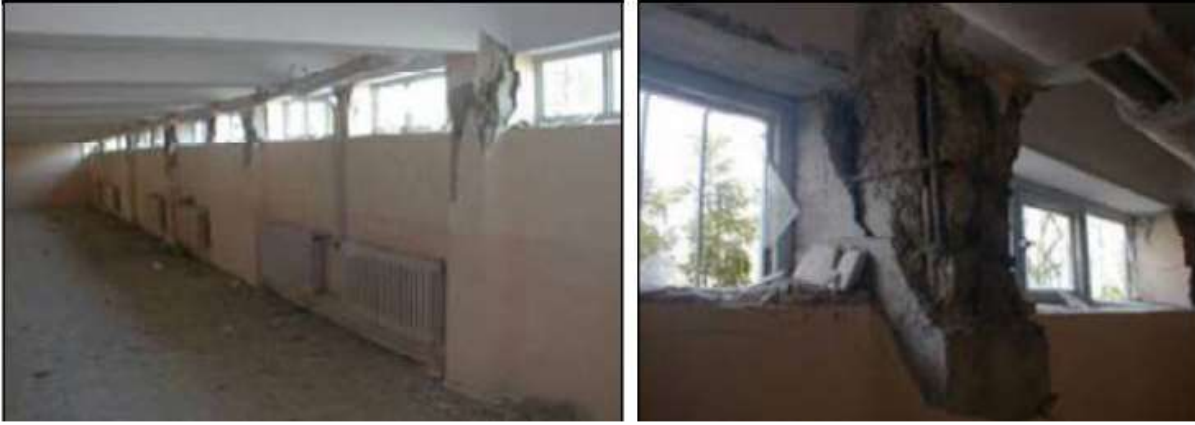
Şekil 12. 1999 Düzce depreminden sonra bir okulda gözlenen kısa kolon hasarları (İrfanoğlu (2009)).
