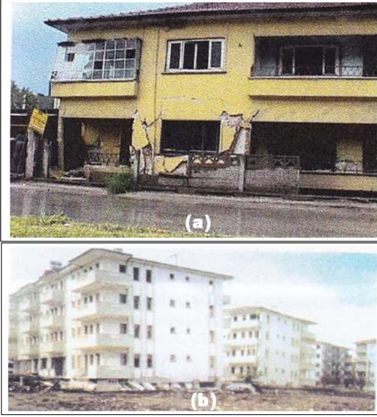
Şekil 9. 17 Ağustos depremi sonrası görülen kısa kolon hasarı örnekleri (Karaesmen (1999))
