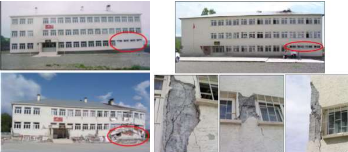
Şekil 13. 1 Mayıs 2003 Bingöl depreminden sonra kısa kolon davranışının da etkisiyle hasar gören okul binaları (İrfanoğlu (2009)).
