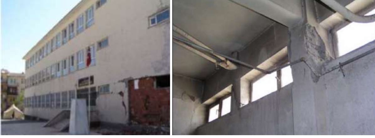
Şekil 14. 1 Mayıs 2003 Bingöl depreminden sonra okul binalarında gözlenen kısa kolon hasarları (İrfanoğlu (2009)).
