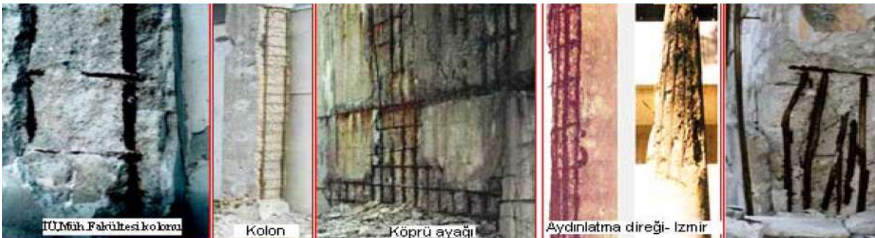
Şekil 2. Korozyon sonucu pas payı betonu dökülmüş örnekler (Doğan (2009)).
