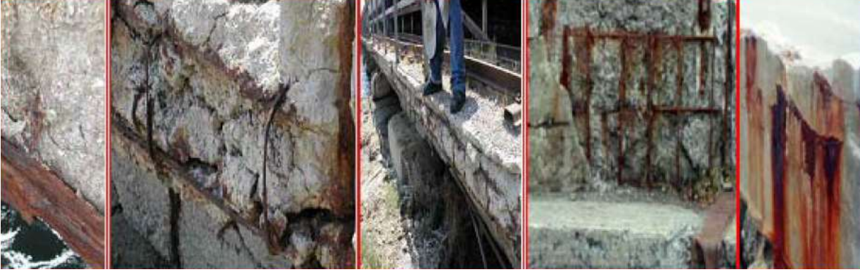
Şekil 3. Deniz kenarında korozyona uğramış yapı örnekleri (Doğan (2009)).
