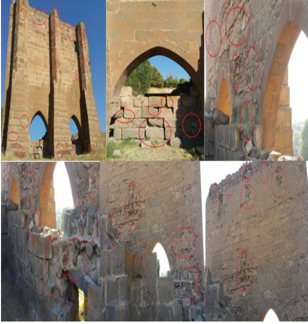
Şekil 3. Beden duvarında gözlemlenen hasarlar
