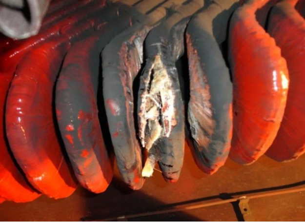
Şekil 1. Stator sargı patlaması
