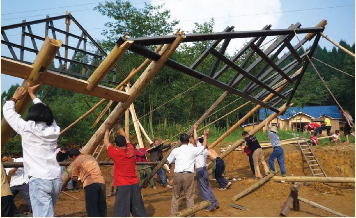
Şekil 12: Da Ping Köyü'nde köy halkı bir ahşap ChuanDou çerçeve elemanı ayağa kaldırırken ( https://www.world-habitat.org/world-habitat-awards/winners-and-finalists/sustainable-village-post-earthquake-reconstruction-and-rehabilitation-in-da-ping-village-sichuan/ )
