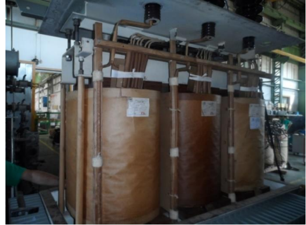
Şekil 1. İncelenen transformatör (Studied transformer)
