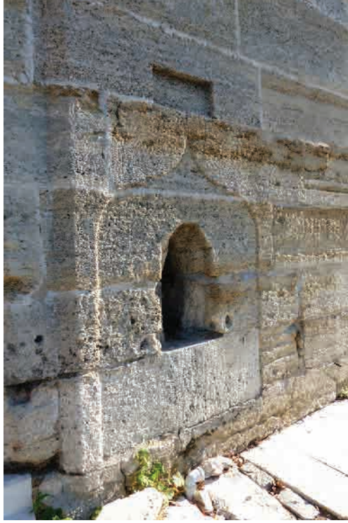
G. 4. Selimiye Külliyesi Duvar Çeşmesi Zeminde Görülen Plastik Tahliye Borusu, (N. Ç. Akçıl Harmankaya, 2018)
